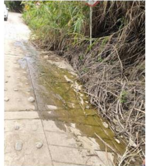
Imagen 24. Señalización y filtro con falta de mantenimiento [Fotografía]
