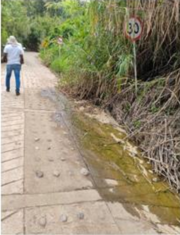
Imagen 27. Señalización obstruida [Fotografía]
