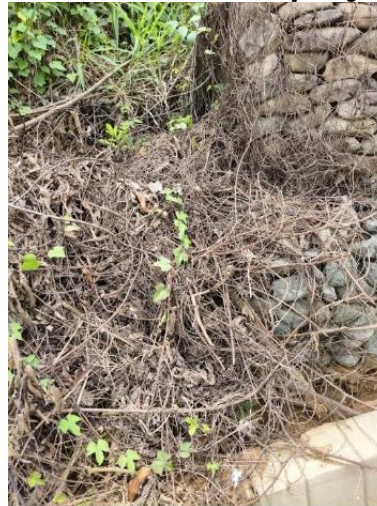
Imagen 29 Muro de gaviones, falta de mantenimiento [Fotografía]
