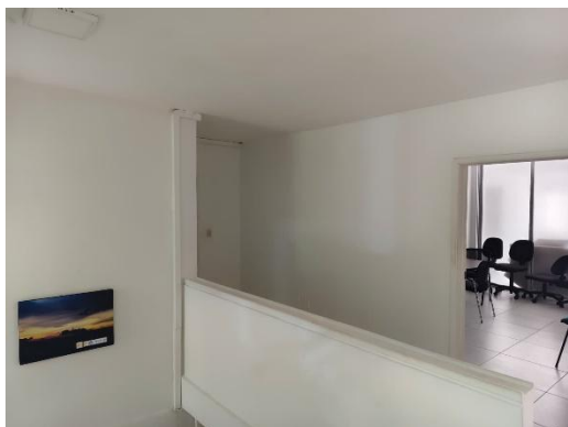
Imagen 6. Ausencia de señalización
