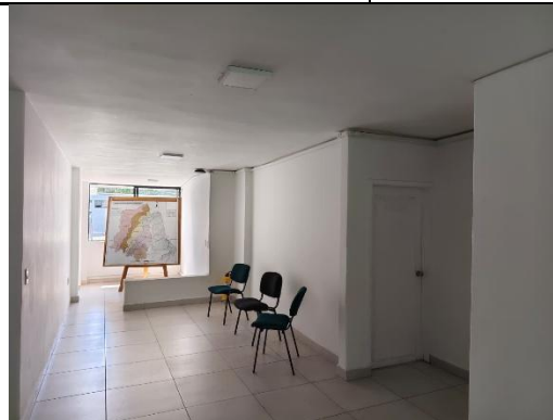
Imagen 5. Ausencia de señalización
