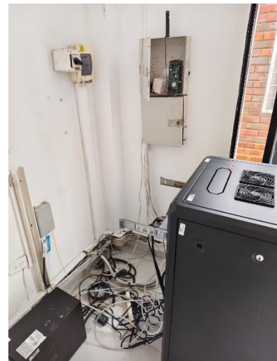
Imagen 10. Estado Cuarto Rack
