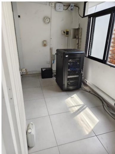
Imagen 8. Estado Cuarto Rack
