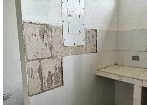
Estado actual del enchape de pared - cocina
