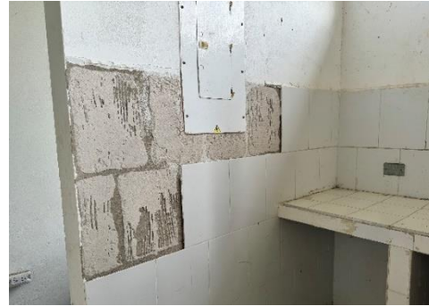
Estado actual del enchape de pared - cocina
