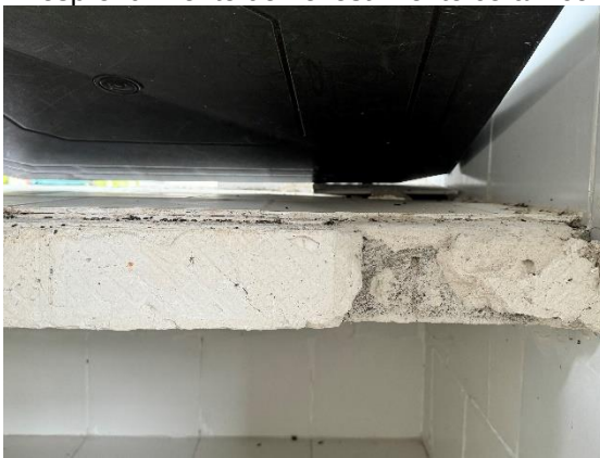
Enchape de mesón desprendido y evidente capa de pegamento de grueso espesor que se desmorona fácilmente
