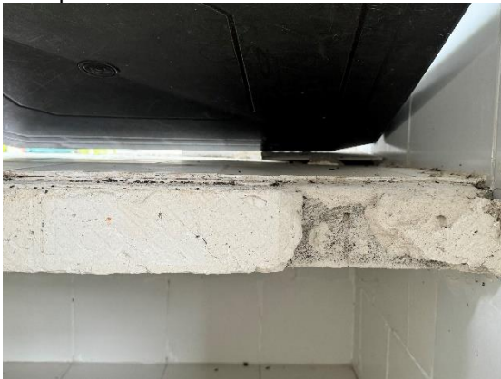
Enchape de mesón desprendido y evidente capa de pegamento de grueso espesor que se desmorona fácilmente
