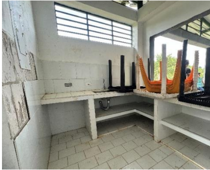
Desprendimiento del revestimiento cerámico
