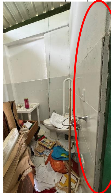
Desprendimiento del revestimiento cerámico Baño para personas con movilidad reducida
