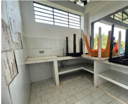
Desprendimiento del revestimiento cerámico
